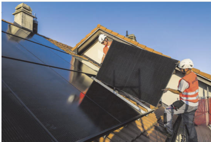
Die Banken werden Kredite für energetische Sanierungen und PV-Anlagen zinsfrei anbieten. Bild: Keystone
