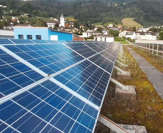
Die erste PV-Anlage der Solargenossenschaft – 1994 auf dem Dach der Primarschule Triesen erbaut – funktioniert 29 Jahre später immer noch.
