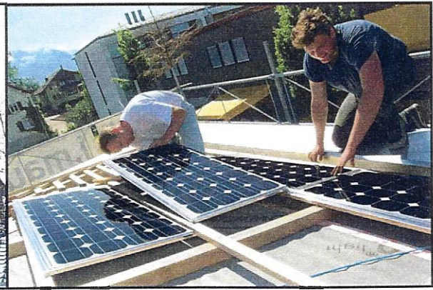
3 kW-Anlage, Fam. Hubert Lampert, Im Popers, Mauren
