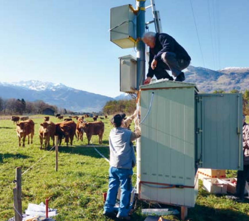
Installation der Föhn- turbulenzmessgeräte in Hälos, Triesen
